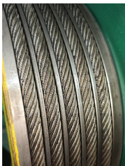
Общее фото тяговых канатов до проведения смазочных работ
